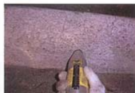
シュミレットハンマー試験 コンクリート圧縮強度確認状況
